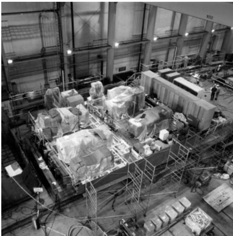
On reconnaît facilement les salles des machines avant et arrière du NCSM Nanaimo par la présence des deux grosses génératrices à diesel. À l'avant de la salle des machines avant se trouve le compartiment du tableau de distribution principal. (HSC96-0721-11)
